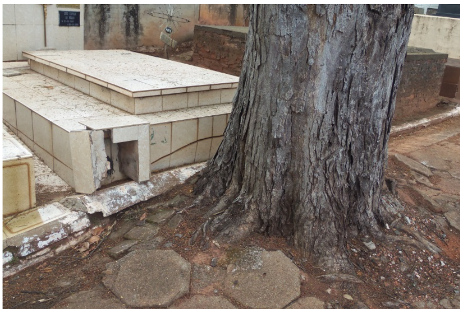
FIGURA 4 - Túmulos quebrado pelas raízes presentes no cemitério A
