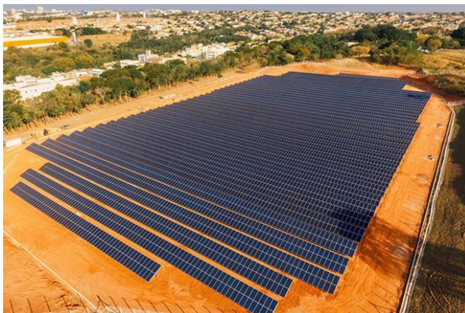
Figura 3 - Usina Solar Fotovoltaica inaugurada no campus II da Unoeste, em março de 2019
