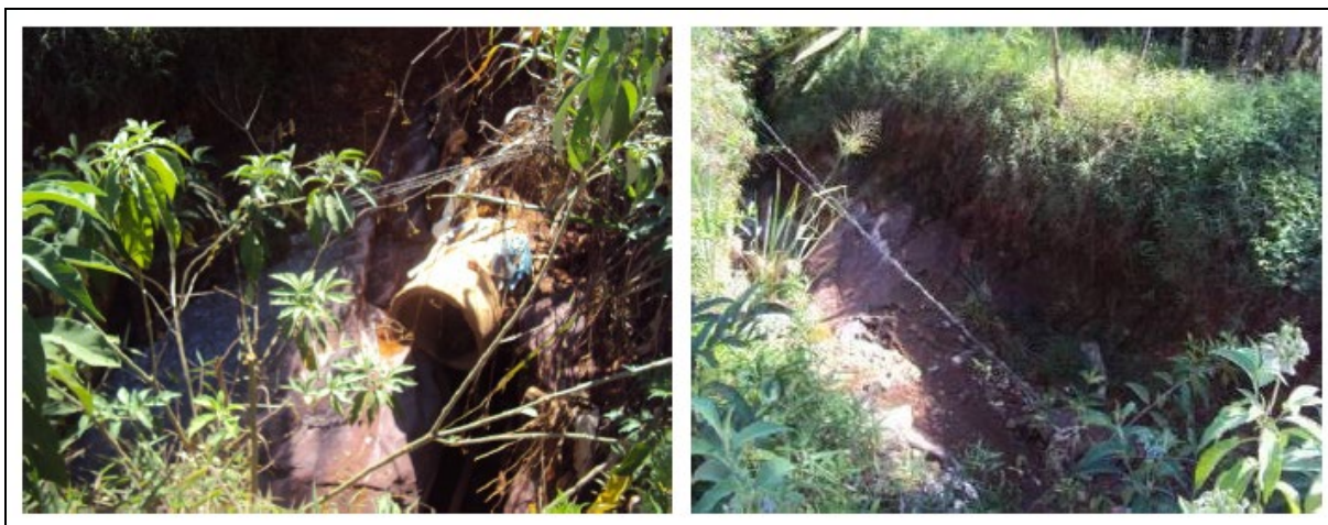
Figura 8- Lançamento Clandestino e processo erosivo decorrente
