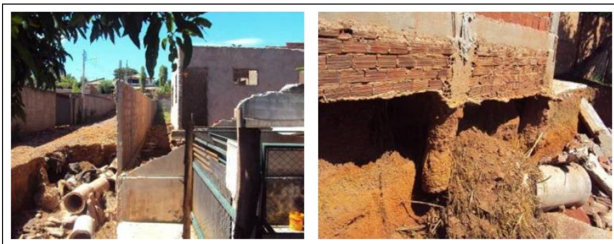
Figura 6- Rede de drenagem colapsada e fundação exposta devido a erosão causada pelas águas da chuva
