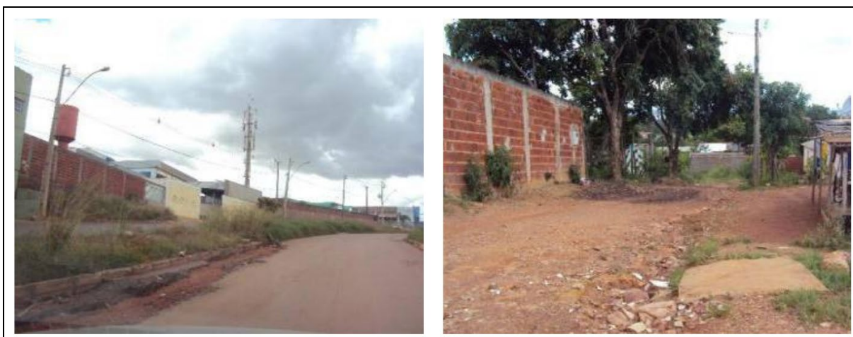
Figura 7- Erosão das vias públicas
