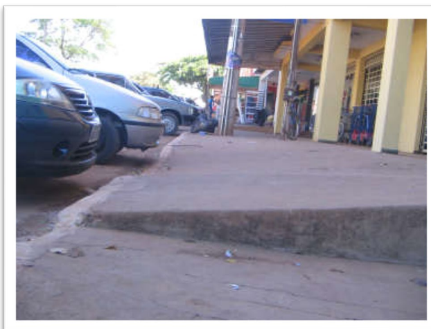
Figura 37— Desnível de calçada entre edificações
