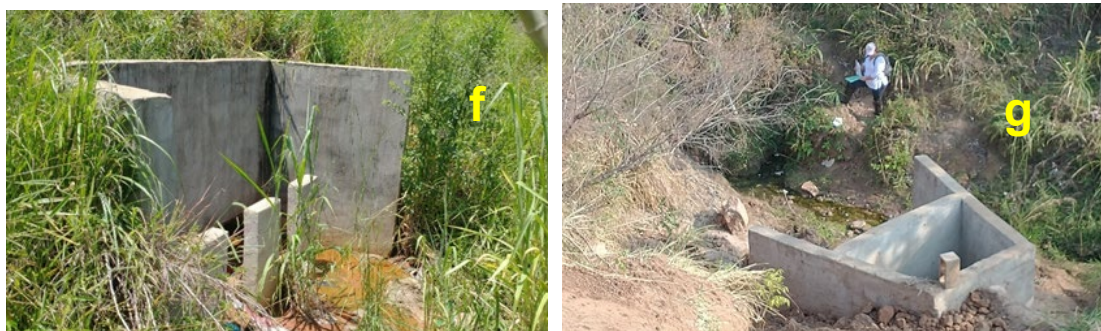
Figura 14 (f) — Dissipador de energia da drenagem de águas pluviais do Bairro Jardim Panorâmico e (g) Dissipador de energia da drenagem de águas pluviais do Bairro Parque Imperial
