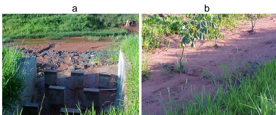
Figura 33 - Saída da rede de águas pluviais no córrego da Malandra e árvores em APP, soterradas.
