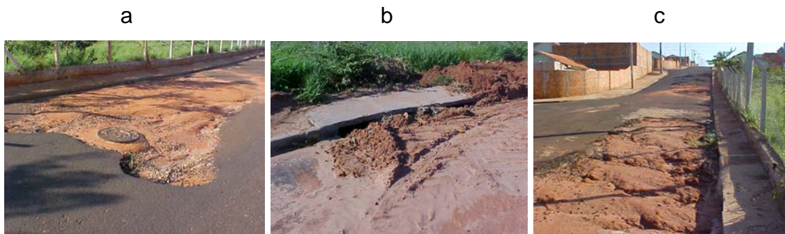
Figura 26 - Estragos na infraestrutura do Maré.
