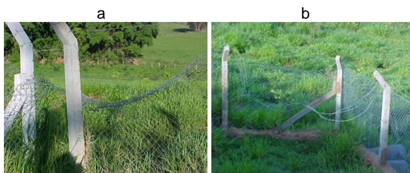
Figura 14 - Pontos da cerca de alambrado danificados.
