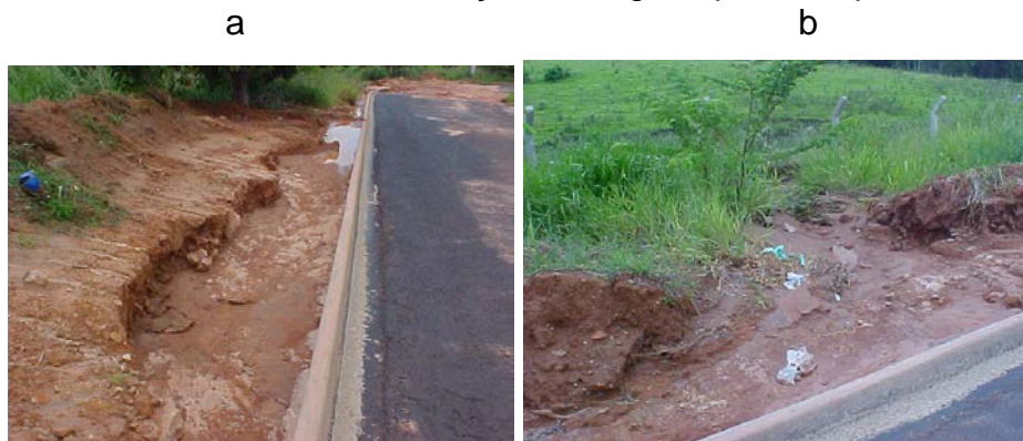
Figura 27 - Meio fio erodido em função das águas pluviais que o transbordam.
