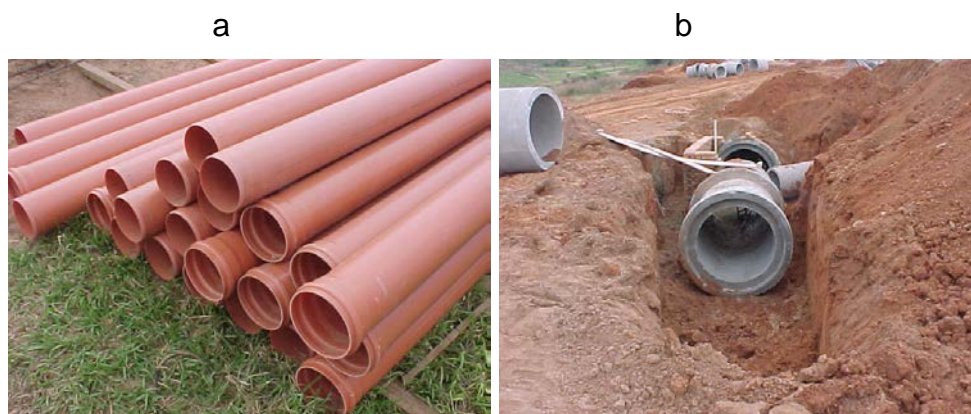
Figura 25 - Tubos utilizados para o esgoto na APP, à esquerda; à direita, tubos da rede de água pluviais, na Área de Preservação Permanente.
