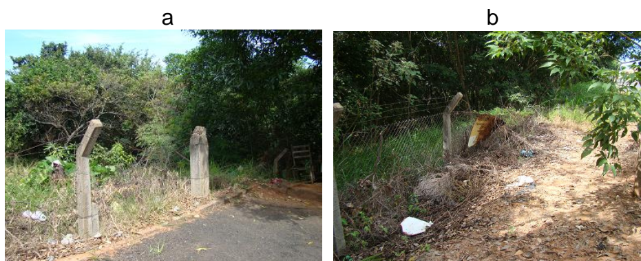
Figura 17 - Pontos em que a cerca encontra-se destruída.
