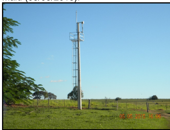
FIGURA 41 – Antena para interligação via satélite da sala do Acessa SP no PA Malu (05/05/2015).
