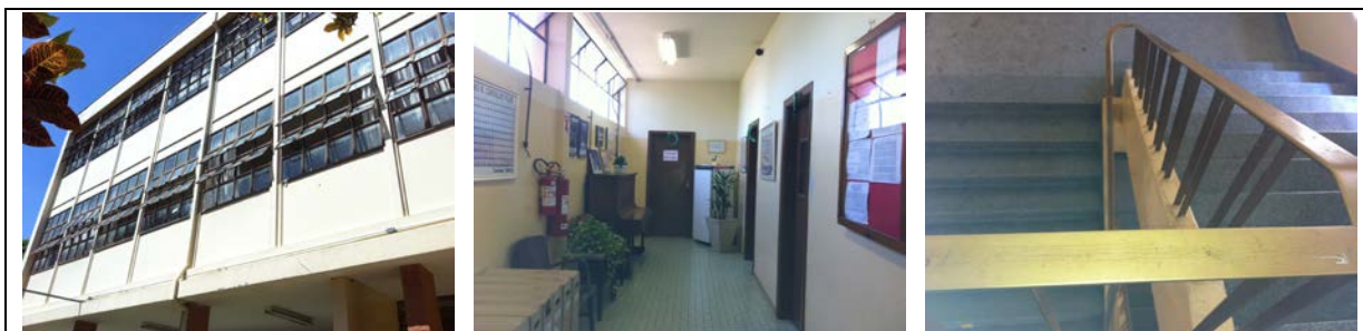
FIGURA 3 - EE “Antônio Marinho de Carvalho Filho” detalhes da arquitetura escolar da década de 60 – janelas, corredores e escadas.
